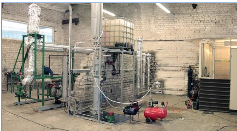
Рисунок 7. Опытно-промышленная установка для термолизной переработки резиновой крошки
